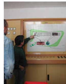
Erläuterungen durch die Klärwärter des RHV
