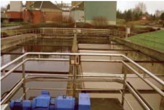
Abb. 6: Die Nachklärung, rechts die neuen Einbauten aus Aluminium
