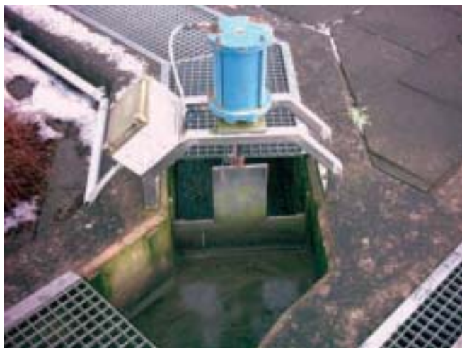
Abb. 2: Selbstgebauter Rinnenschieber im Zulauf zum Nachklärbecken 1
