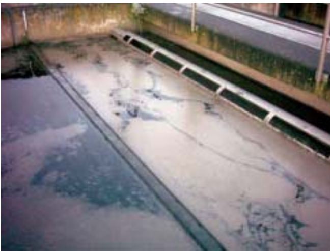
Abb. 5: Angehobene Skim-Rinne mit angestautem Schwimmschlamm
