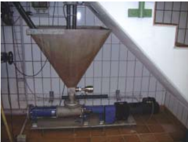
Abb. 3: Trichterpumpe unter der Treppe
