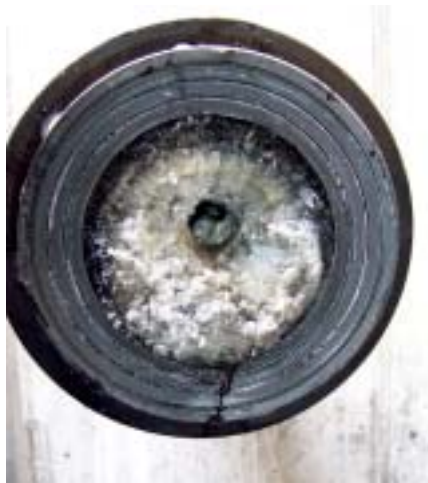
Abb. 2: Rohrleitung vor dem Versuch
