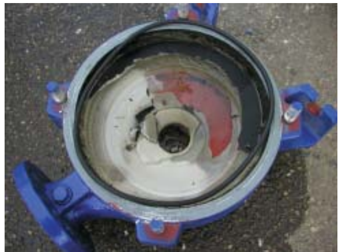
Abb. 4: Das ist vorbei: MAP-Ablagerungen im Pumpengehäuse
