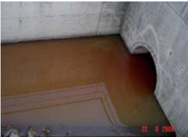
Abb. 2: Das Abwasser-Heizöl-Gemisch wird zum Regenüberlaufbecken umgeleitet
