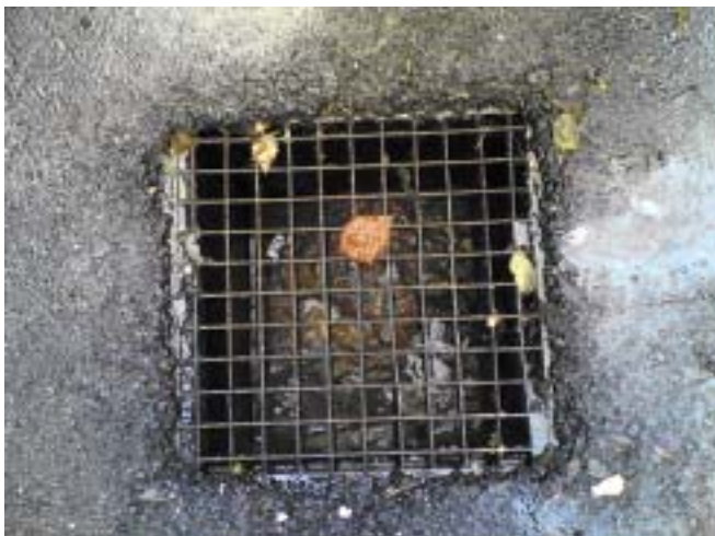
Abb. 5: Fäkalien im Regeneinlauf des Innenhofes – Fehlschluss
