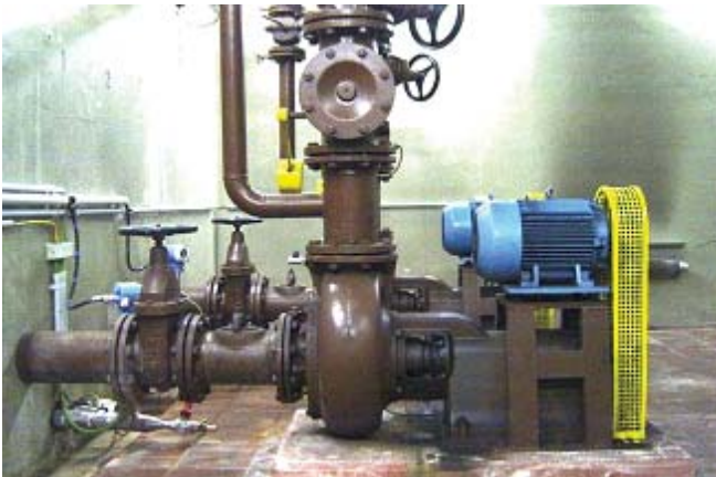
Abb. 1: Pumpe vor dem Umbau
