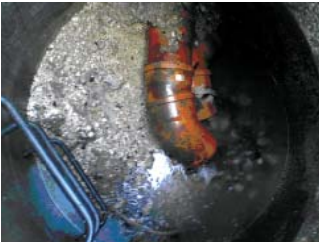
Abb. 1: Jede Menge Sand und Schotter im Kontrollschacht
