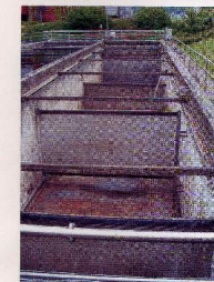
Abb. 1: Nachklärbecken – vorne und in der Mitte die ursprünglichen Folien, die durch zwei weitere Folien ergänzt wurden
