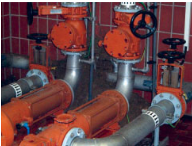
Abb. 1: Das Fett wird mit einer Exzentrerschneckenpumpe gepumpt
