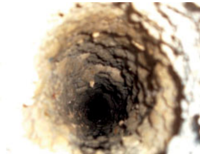
Abb. 3: Deutlich sind die Ablagerungen in der Rohrleitung zu erkennen
