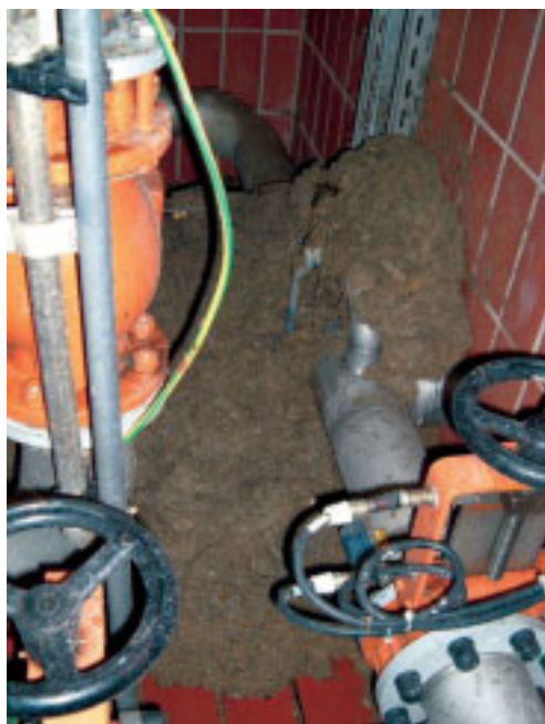
Abb. 2: Schon wieder ist die Leitung verstopft und muss geöffnet werden
